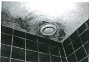
Contamination dans une salle de bain autour de la bouche d'extraction non fonctionnelle Cause : Défaut de ventilation et phénomènes de condensation
